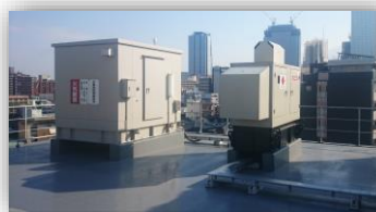
非常用発電機 (非常時の発電)
