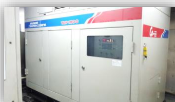
コージェネレーションシステム 運転管理 (Iネギの効率利用)
